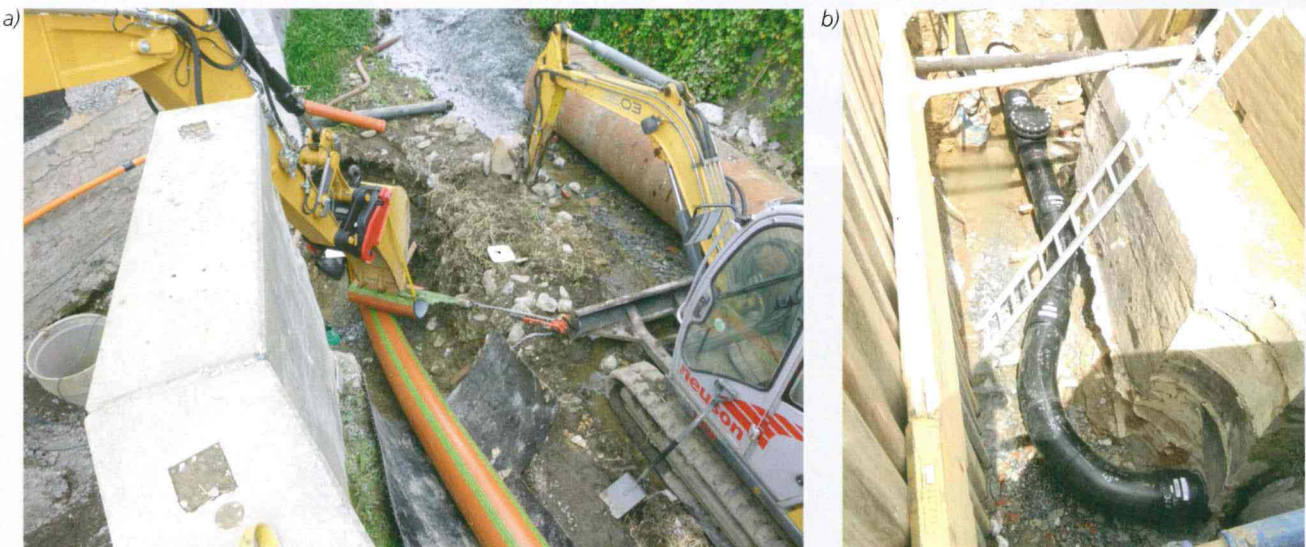
Bild 6: a) Linereinzug unter Gewässersohle der Wäster, b) Übergang von Kurzrohren auf den Liner
